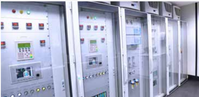
Armadi / Quadri elettrici
